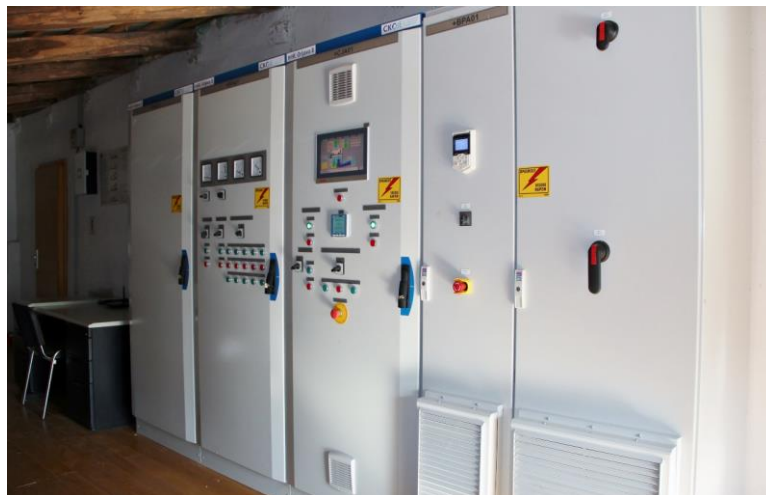
Slika 3. Smještaj upravljačke opreme
